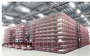
アルプス物流の拠点で稼働を開始したラピタASRS
